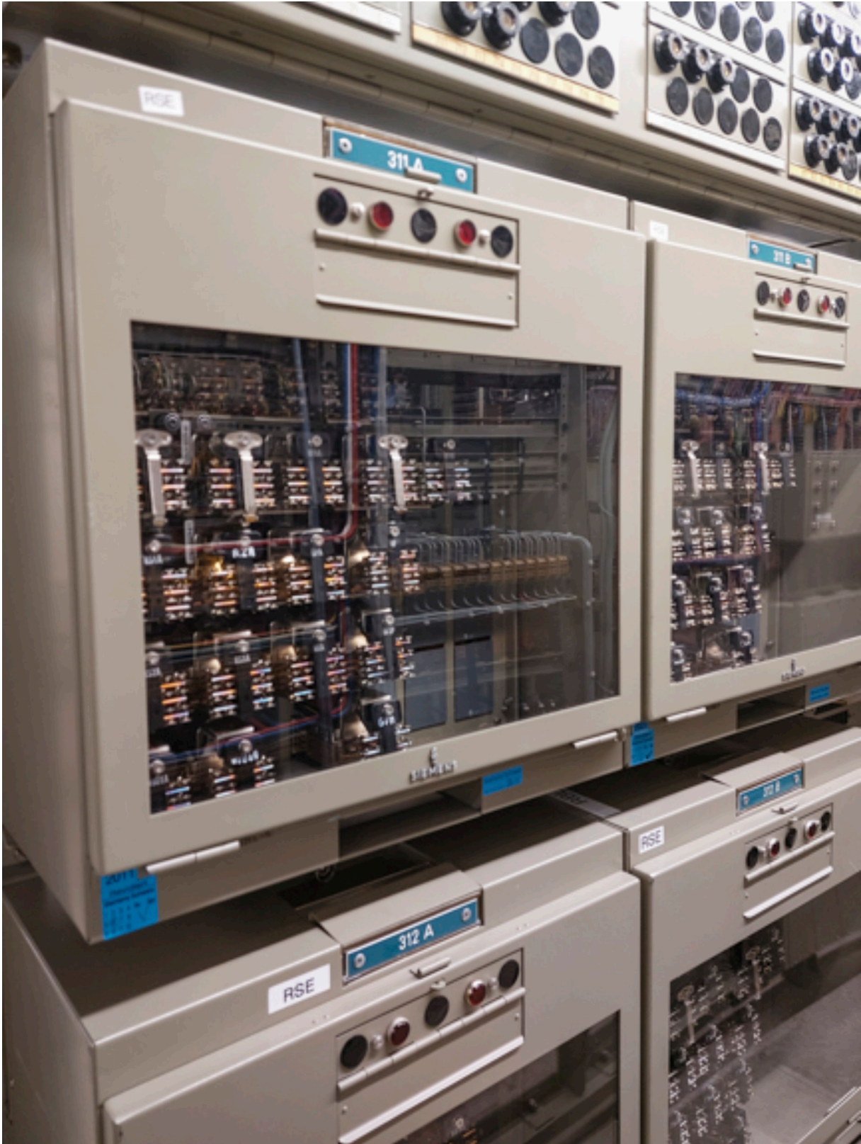
Die Steuerung der Anlage erfolgt heute mit konventioneller Relais-technik aus den 70er Jahren des letzten Jahrhunderts
