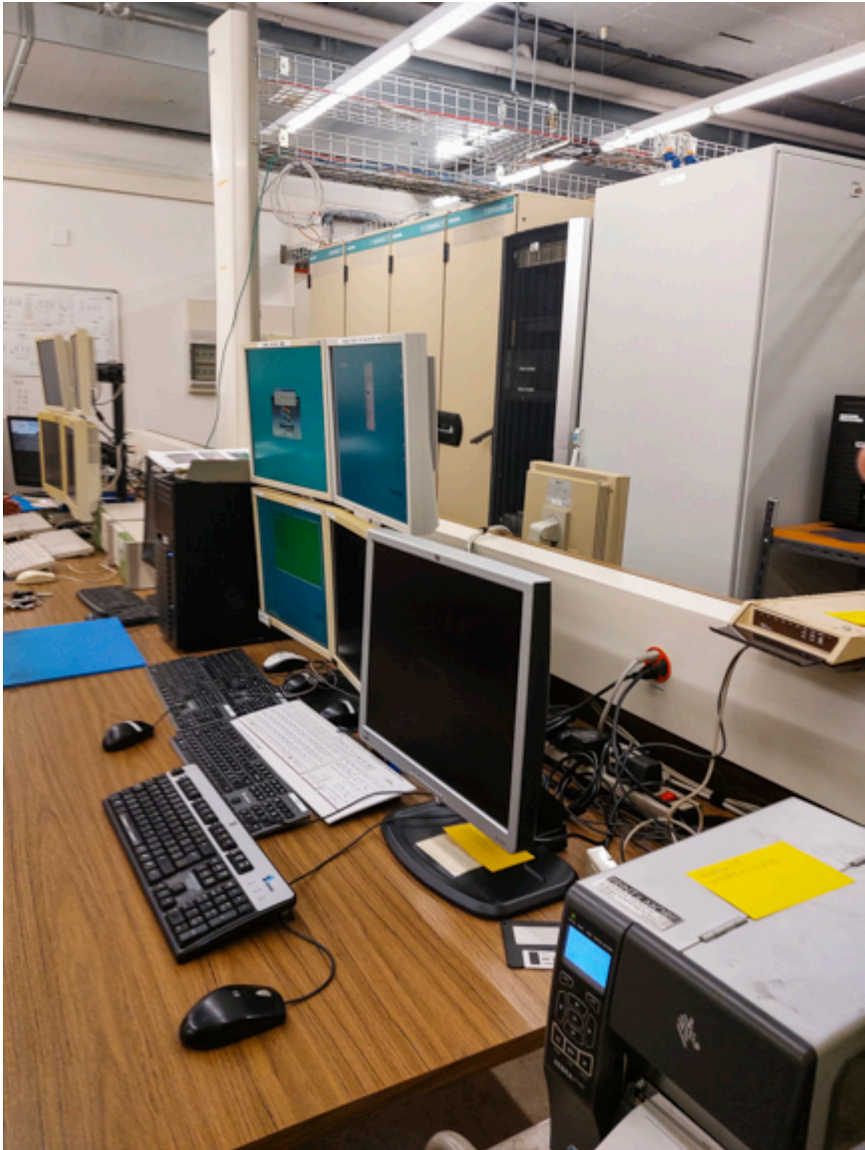
Momentan wird die Steuerung modernisiert
