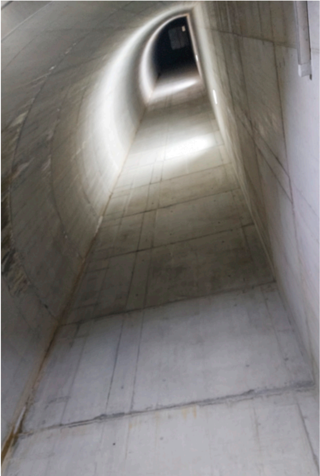
Zubringerschacht zum Stollen
