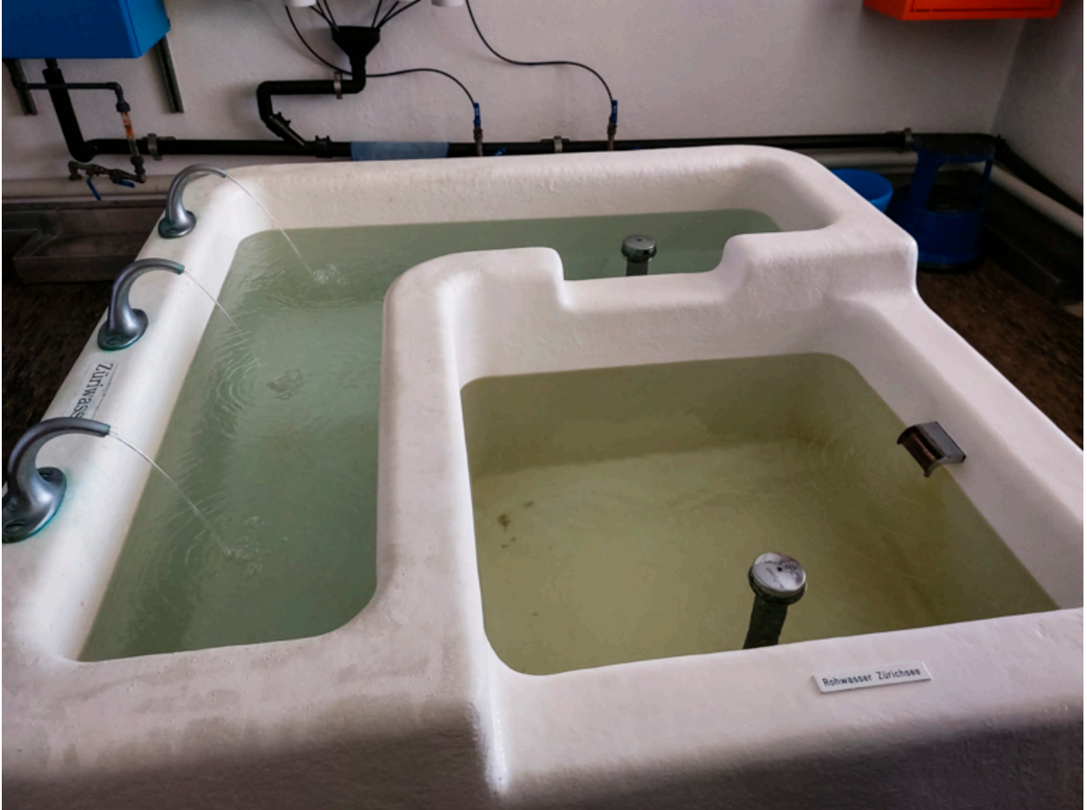
links Zürliwasser, rechts Rohwasser aus dem See
