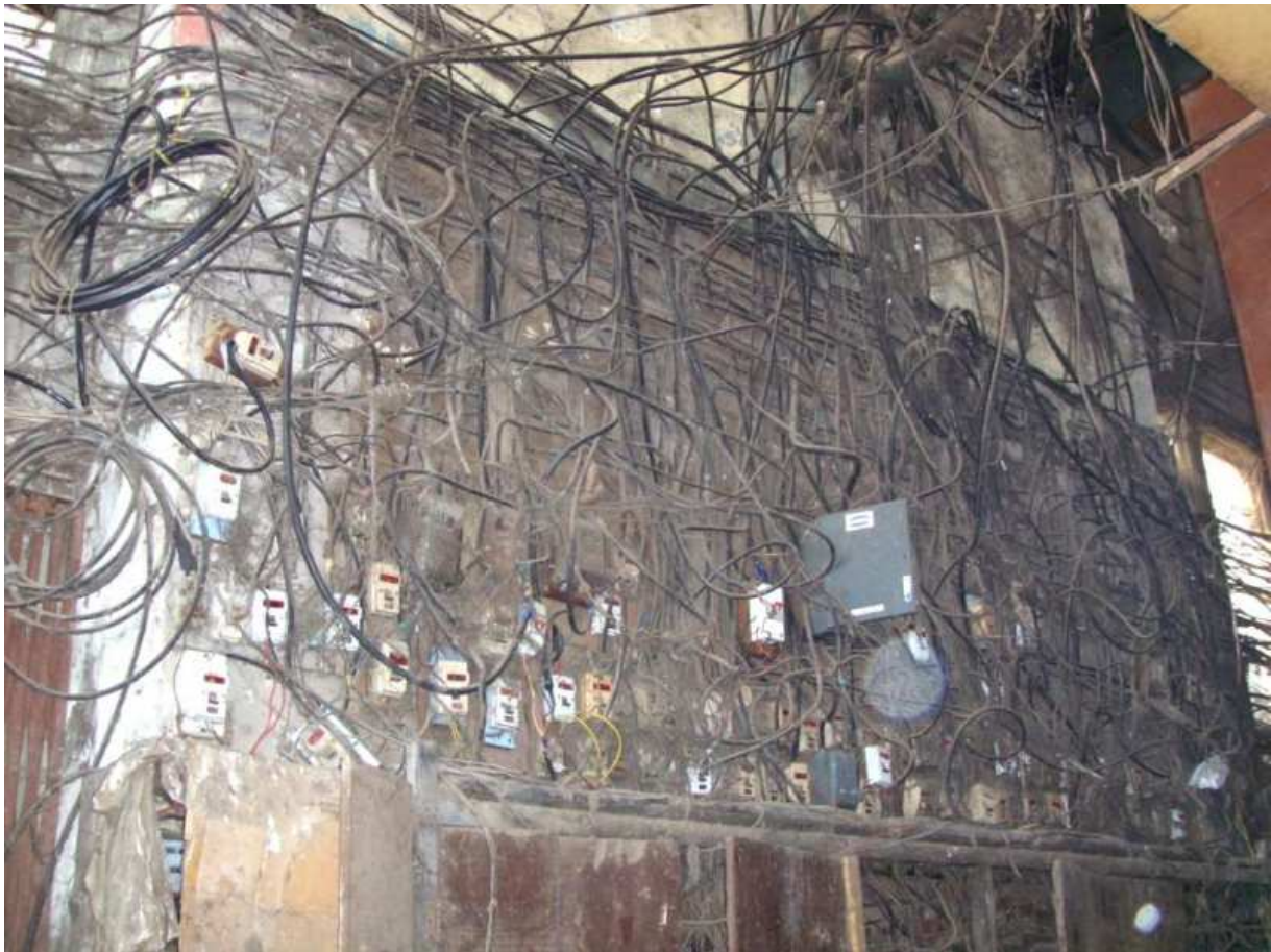
Stromverteiler des Marktes
