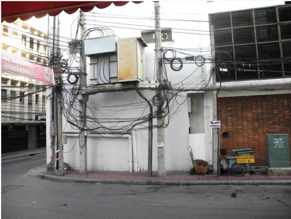
Bei dieser Installationstechnik ist es eigentlich nicht verwunderlich...
