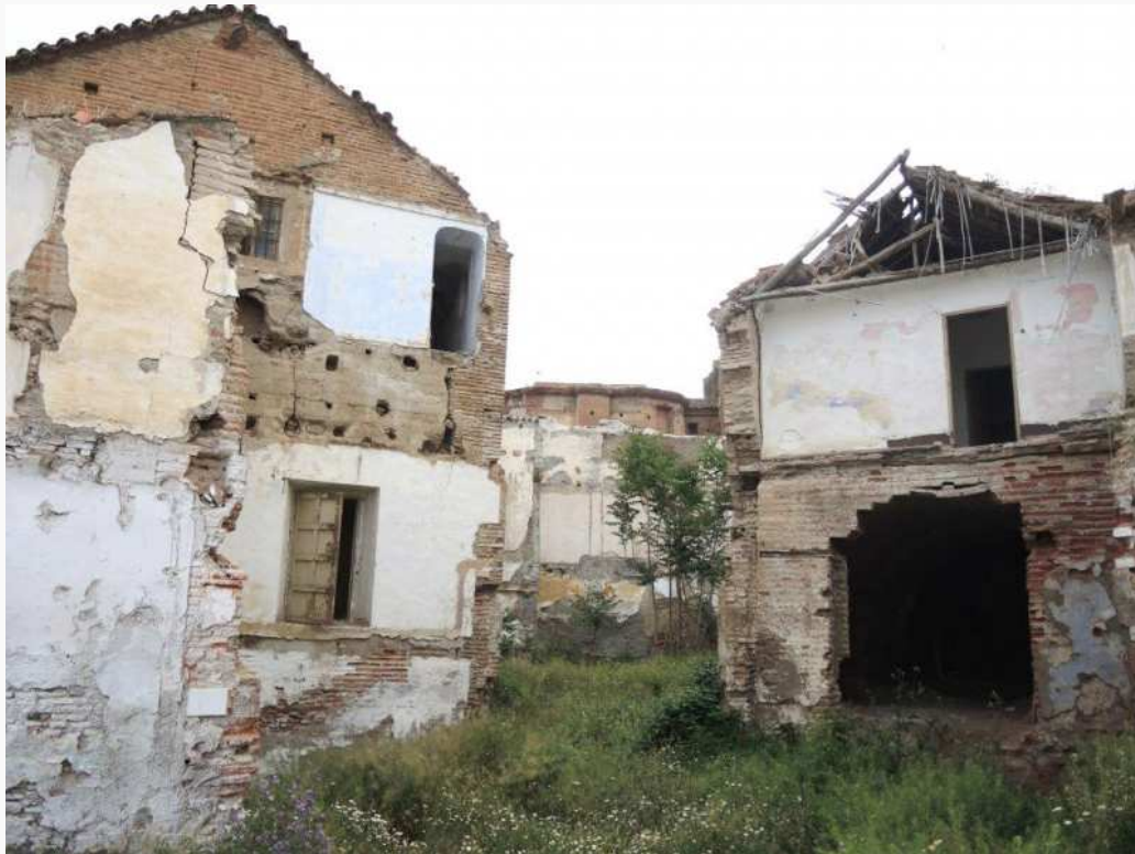
Es gibt auch baufällige Häuser
