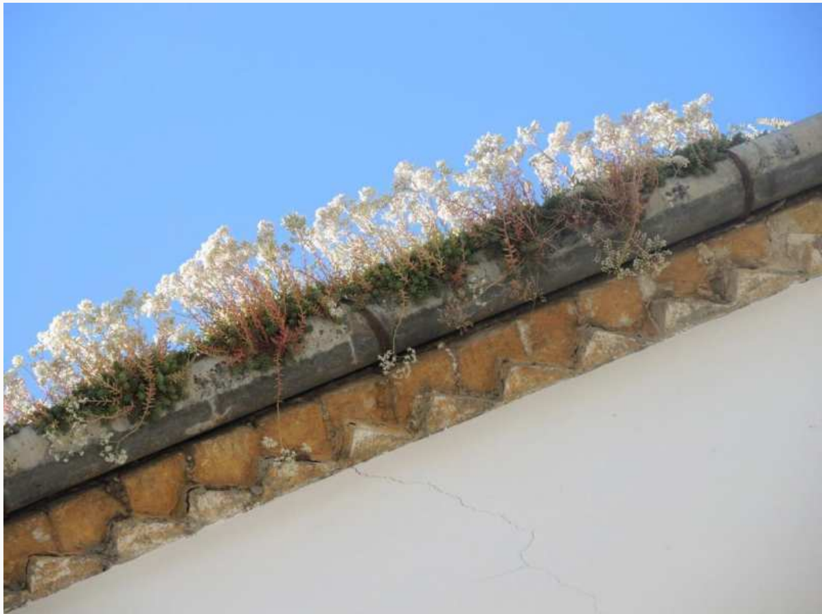
Mauerpfeffer im Dachchännel
