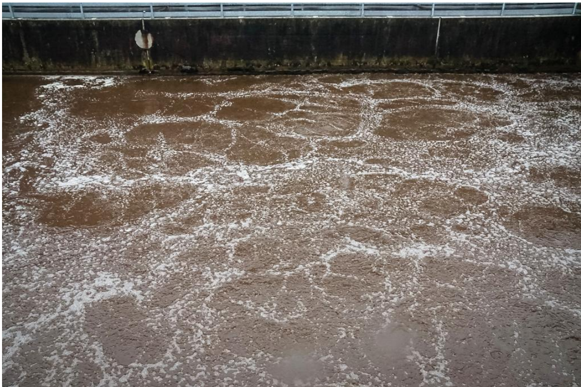
Damit die Mikroorganismen ideale Arbeitsbedingungen haben, werden die Abwasserbecken belüftet
