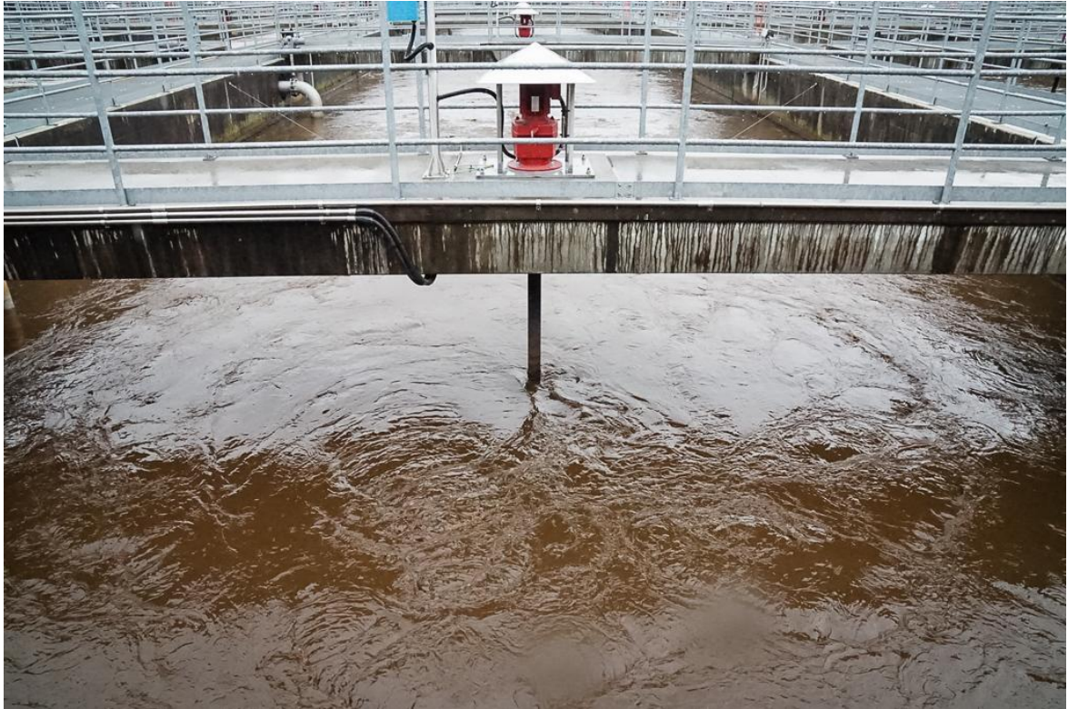
Biologische Reinigung: Hier reinigen Mikroorganismen das Abwasser. Die braune Farbe stammt von der Zugabe von Eisensalzen. Sie dienen der Ausfällung des Phosphors
