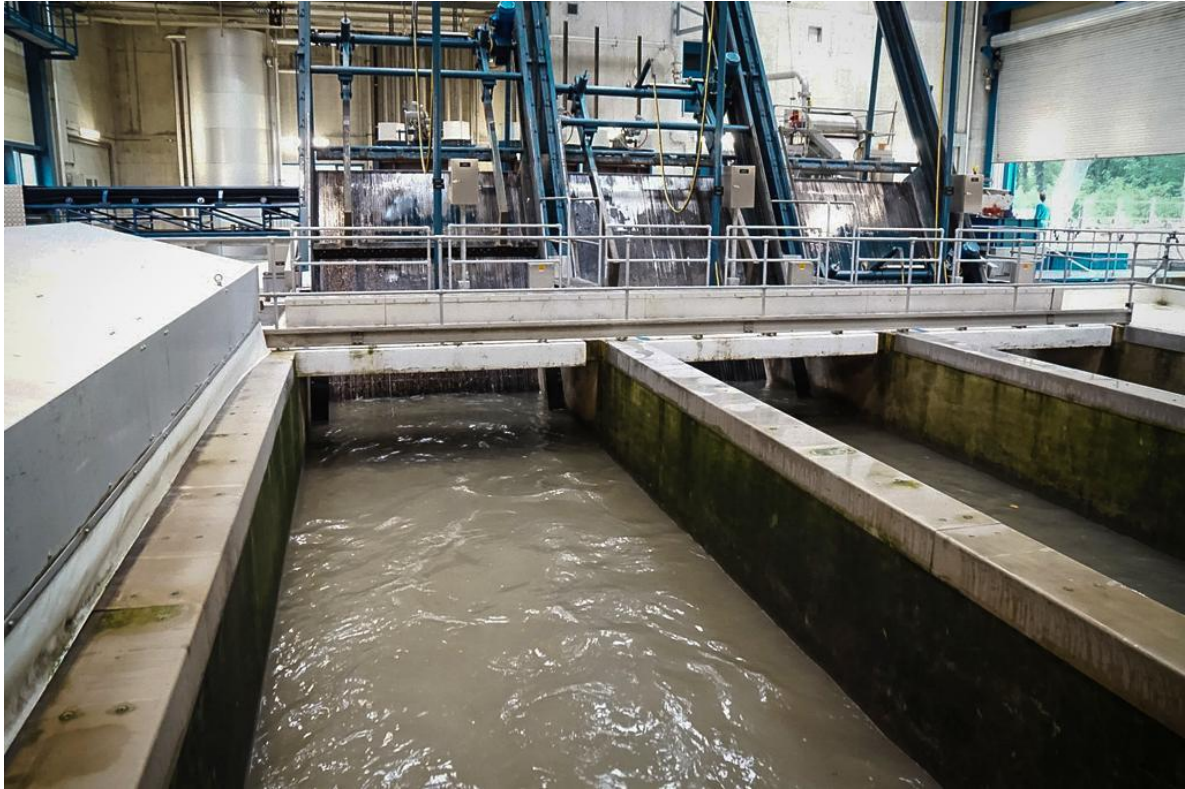
Im Rechengebäude: Hier werden im Grobsandfang grobe Materialien wie Steine und Kies abgesetzt. In der Rechenanlage (hinten) werden feste Bestandteile wie Papier, Speisereste, Textilien etc. zurückgehalten
