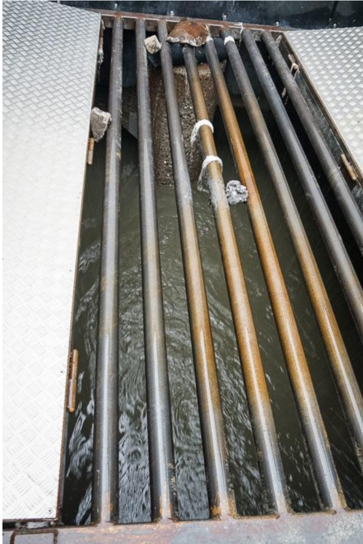
Hier kommt das Abwasser der Stadt Zürich an. Die maximale Kapazität der Anlage beträgt 6 Kubikmeter pro Sekunde
