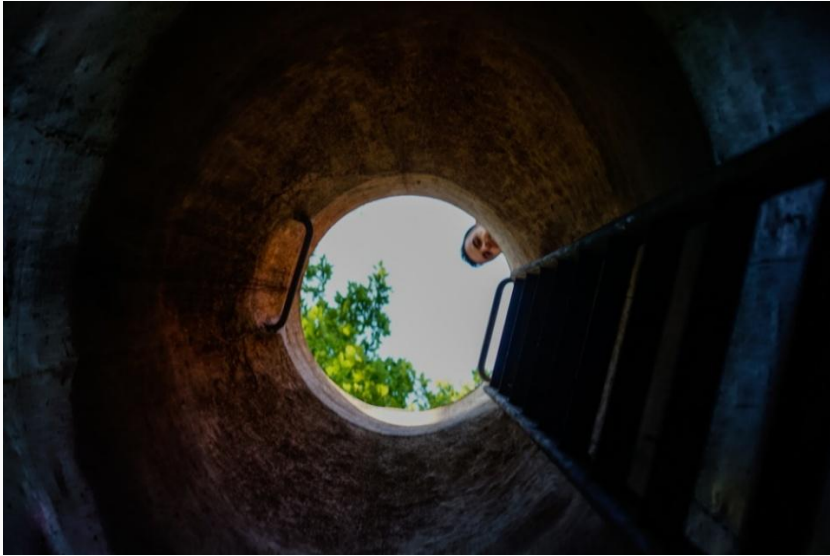
Entlüftungsschacht für unsere Sicherheit
