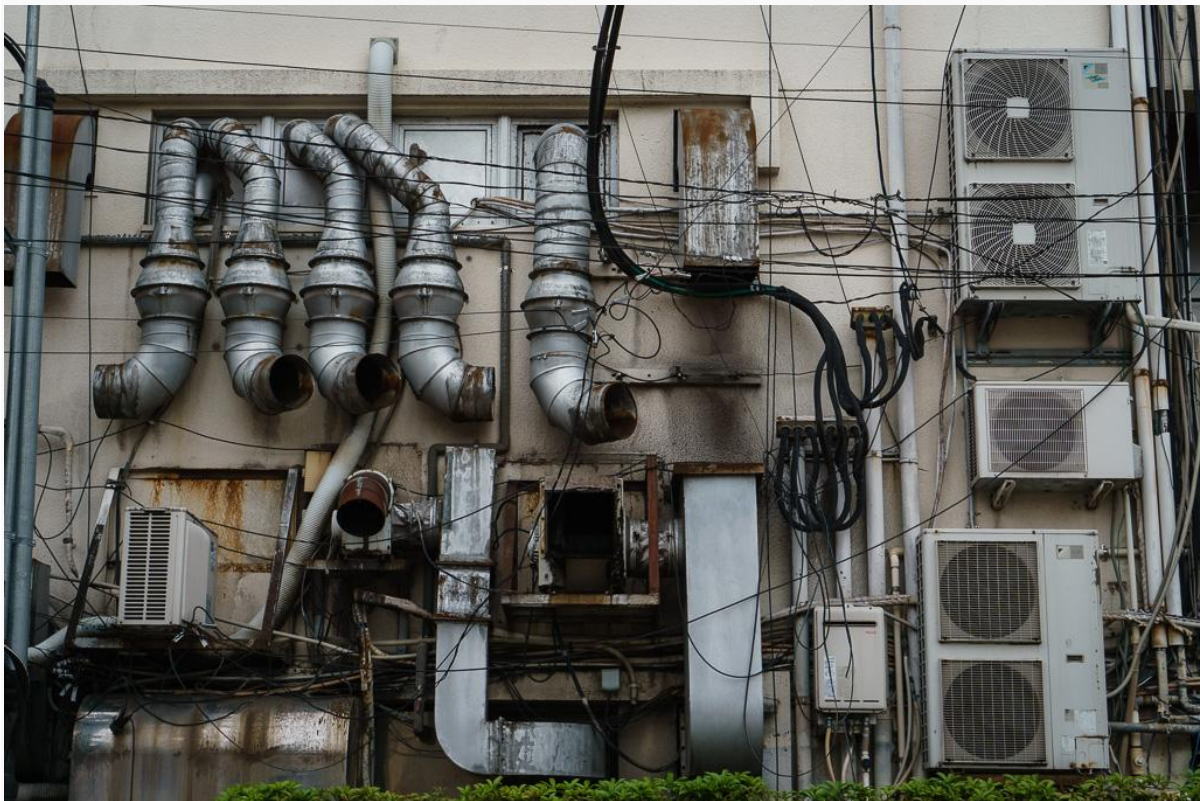
Vorne die Restaurants, hinten die Abluft
