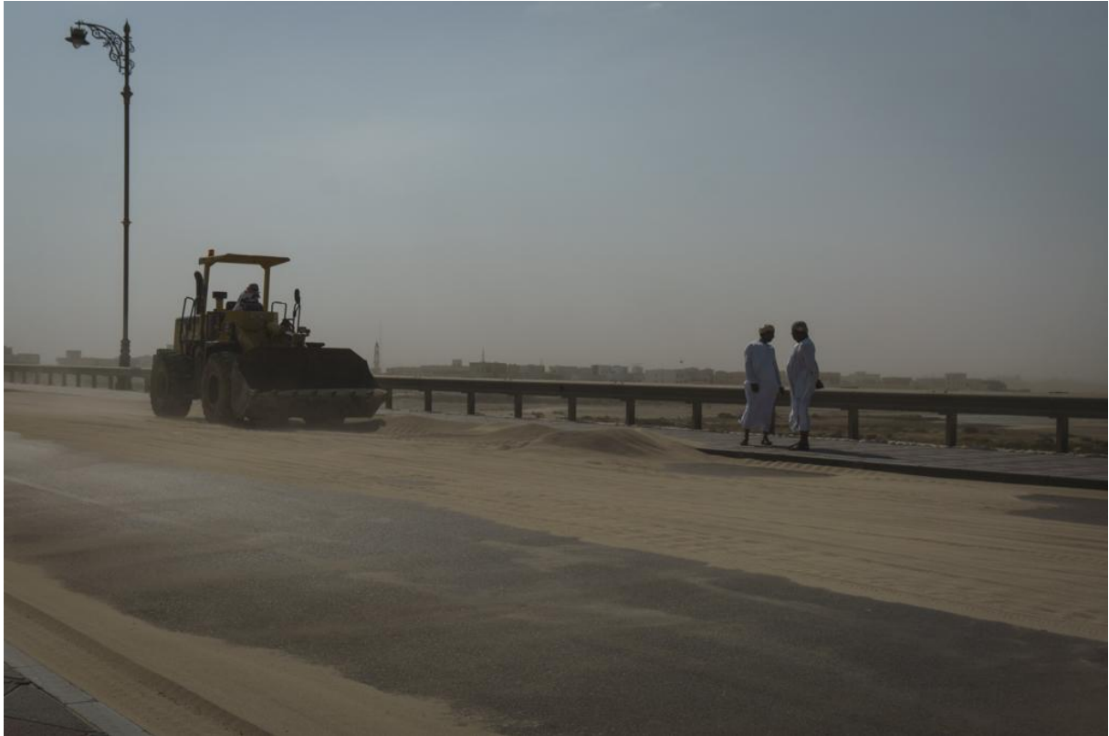
Sandverwehungen auf der Brücke
