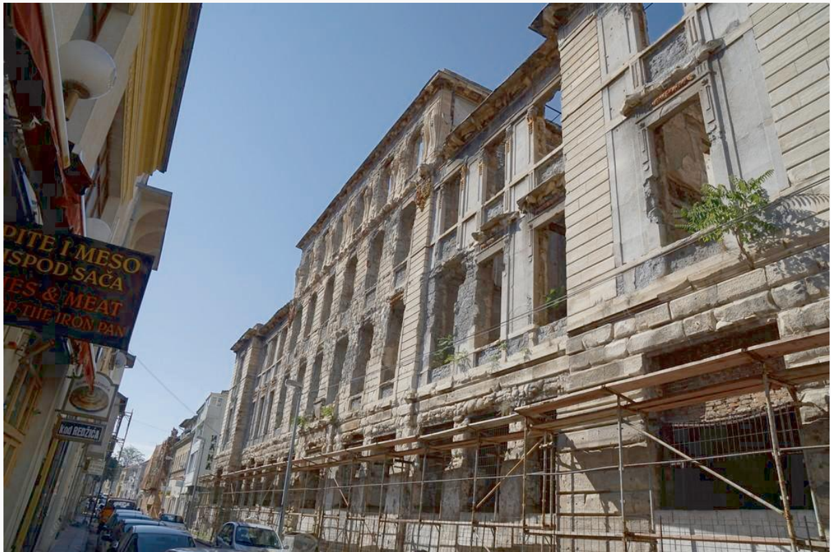
Es gibt immer noch sichtbare Kriegsschäden
