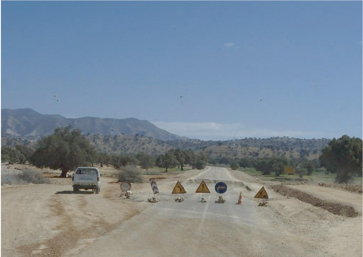
Wegen den Unwettern mit Überschwemmungen im November 2014 wurden viele Strassen beschädigt
