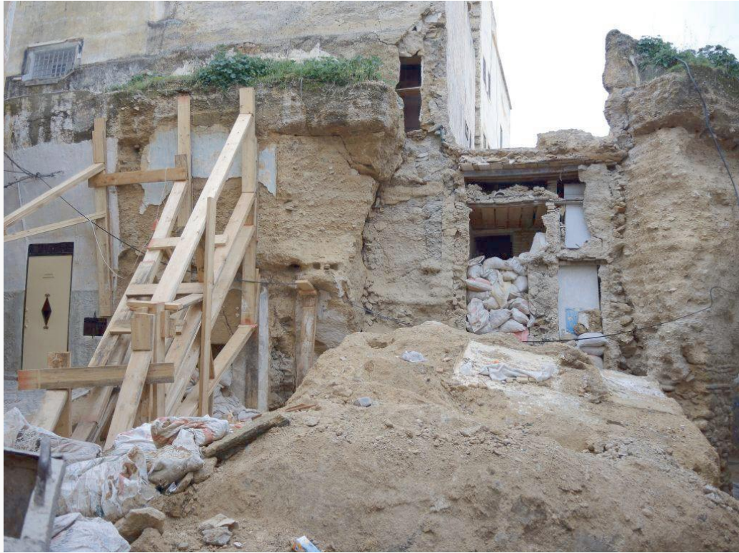
Viele Häuser sind baufällig und müssen aufwändig renoviert werden
